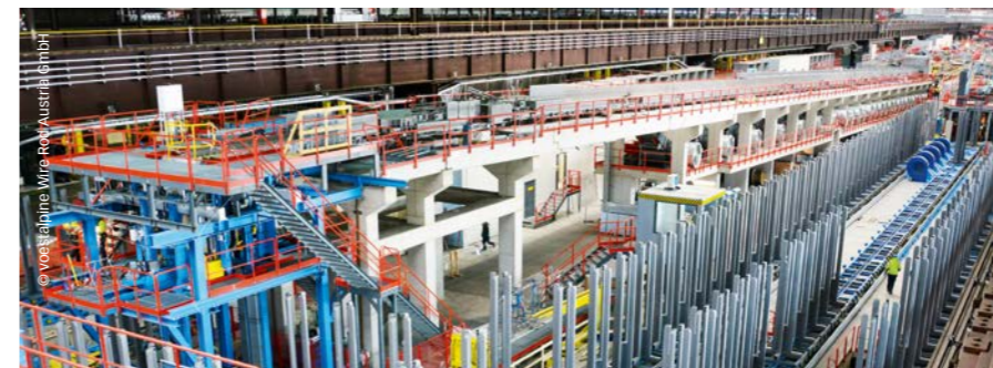
Kühlstrecke bzw. Bundmanipulation unter Betrieb
